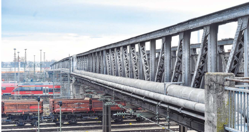
Im Westen muss die verrostete Beringerbrücke über die Bahngleise weg. Daher braucht es eine neue, freilich viel kleinere Brücke für die bisher an die historische Stahlbrücke angehängten Fernwärmeleitungen. Fotos: Lars Schwerdtfeger
